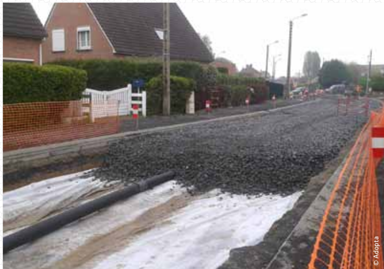
Chaussée à structure réservoir avec infiltration, enrobé classique et bouches d'injection, drain de vidange en fond de structure (ville de Cuincy, 2011).
