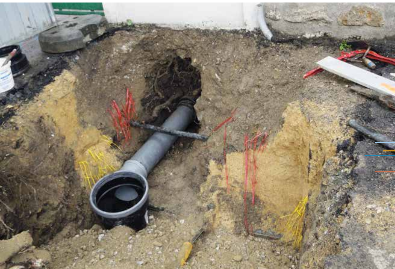
Regard intermédiaire de la partie privée du branchement particulier.
